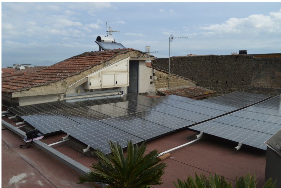
FOTO n. 6 – LASTRICO SOLARE_ con impianto fotovoltaico.
